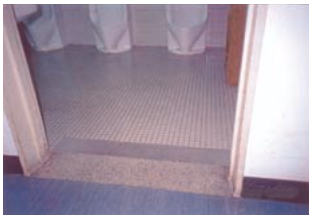
図4 廊下とトイレの段差の解消
