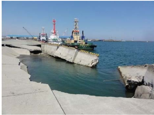
図 1.38 相馬港における被災状況 20)
