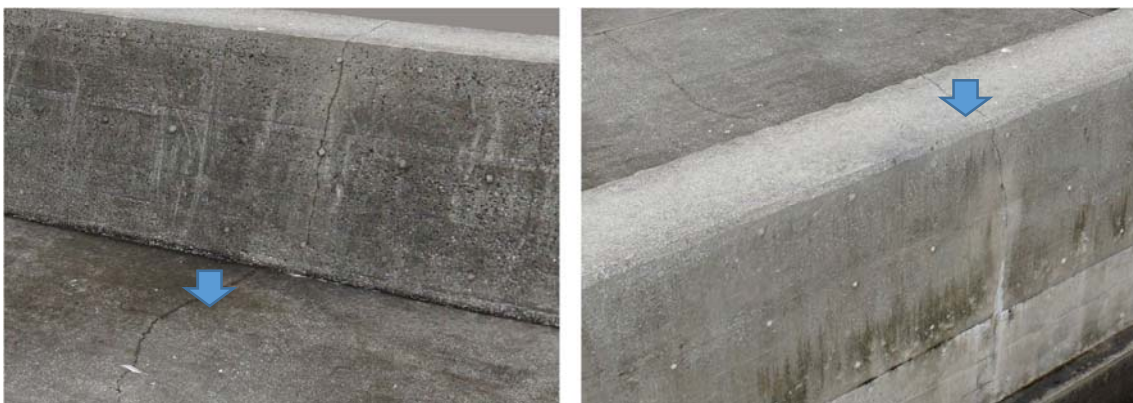
図 2.19 表面状態の確認 (クラック)
