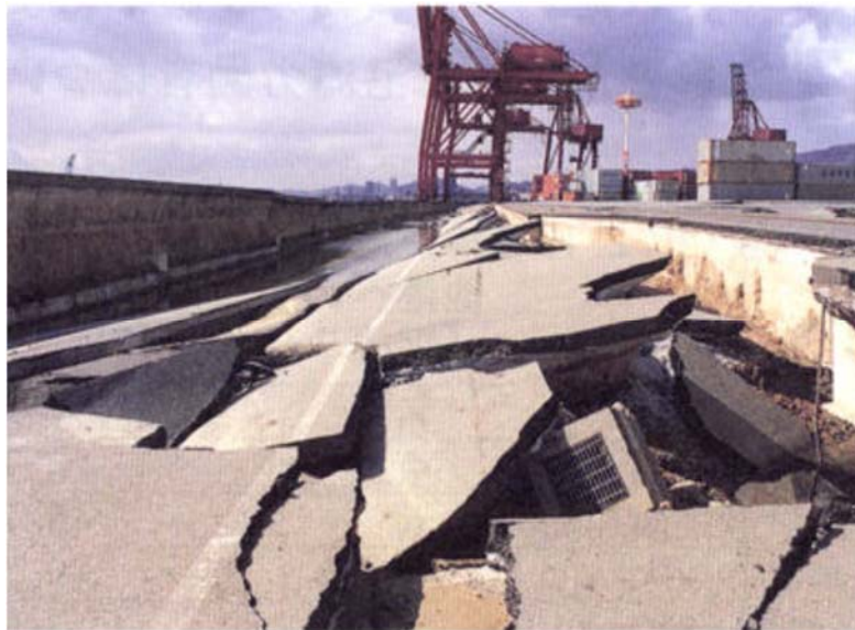
図 1.5 1995年兵庫県南部地震における麻耶コンテナターミナル被災状況 6)
