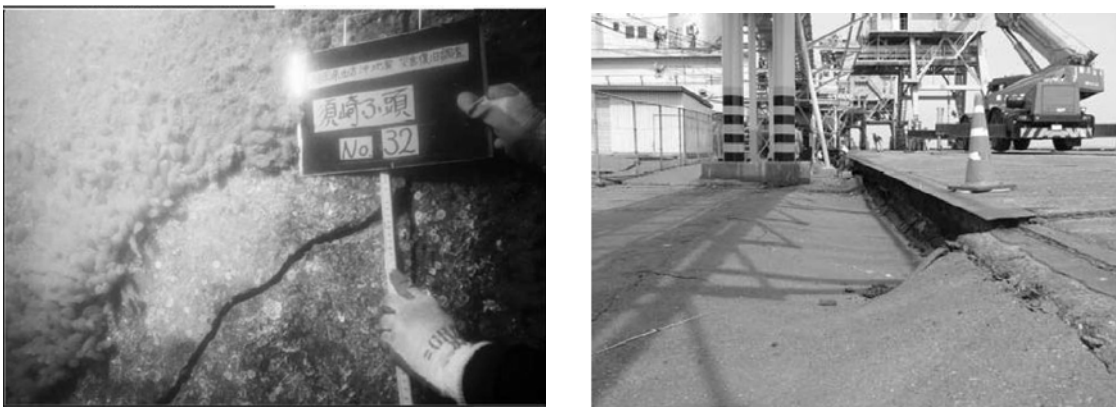
図 1.36 博多港における被災状況（L型ブロック損傷，岸壁背後沈下） 19)
