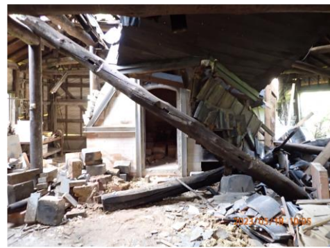
写真-1 工場の損傷状況 (中央に損傷した窯)
