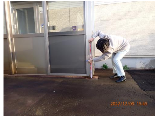
写真-1 N1 保育園での浸水痕跡 (浸水深 0.38m)
