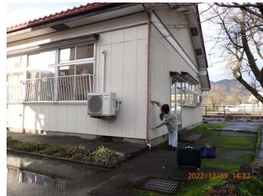
写真-2 N2 保育園での浸水痕跡 (浸水深 0.60m)
