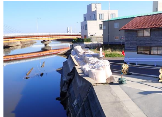
写真-1 堤防の被害状況(河口から約0.1km右岸)
