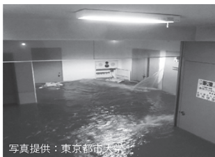
写真－1 地下室への浸水
