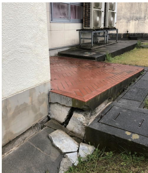
写真6 N-6園周囲の地盤沈下の状況
