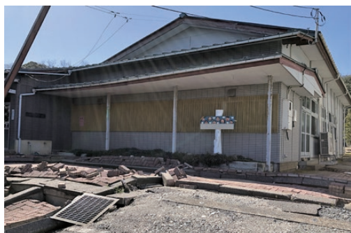
写真8 N-9園周辺の被害状況
