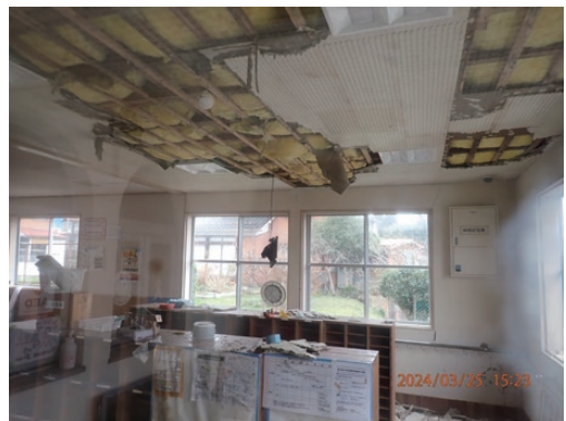
写真4 N-3園内部の被害状況
