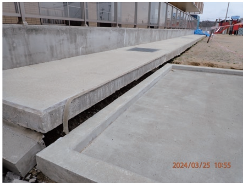
写真1 N-1園の被害の様子
