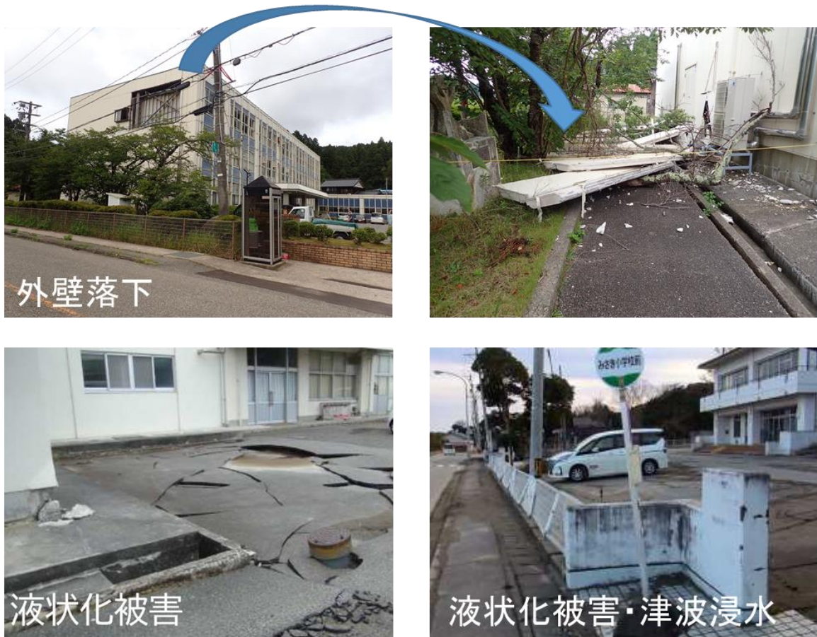
(上段：輪島市立河原田小学校／下段左：輪島市立鳳至小学校／下段右：珠洲市立みさき小学校)
